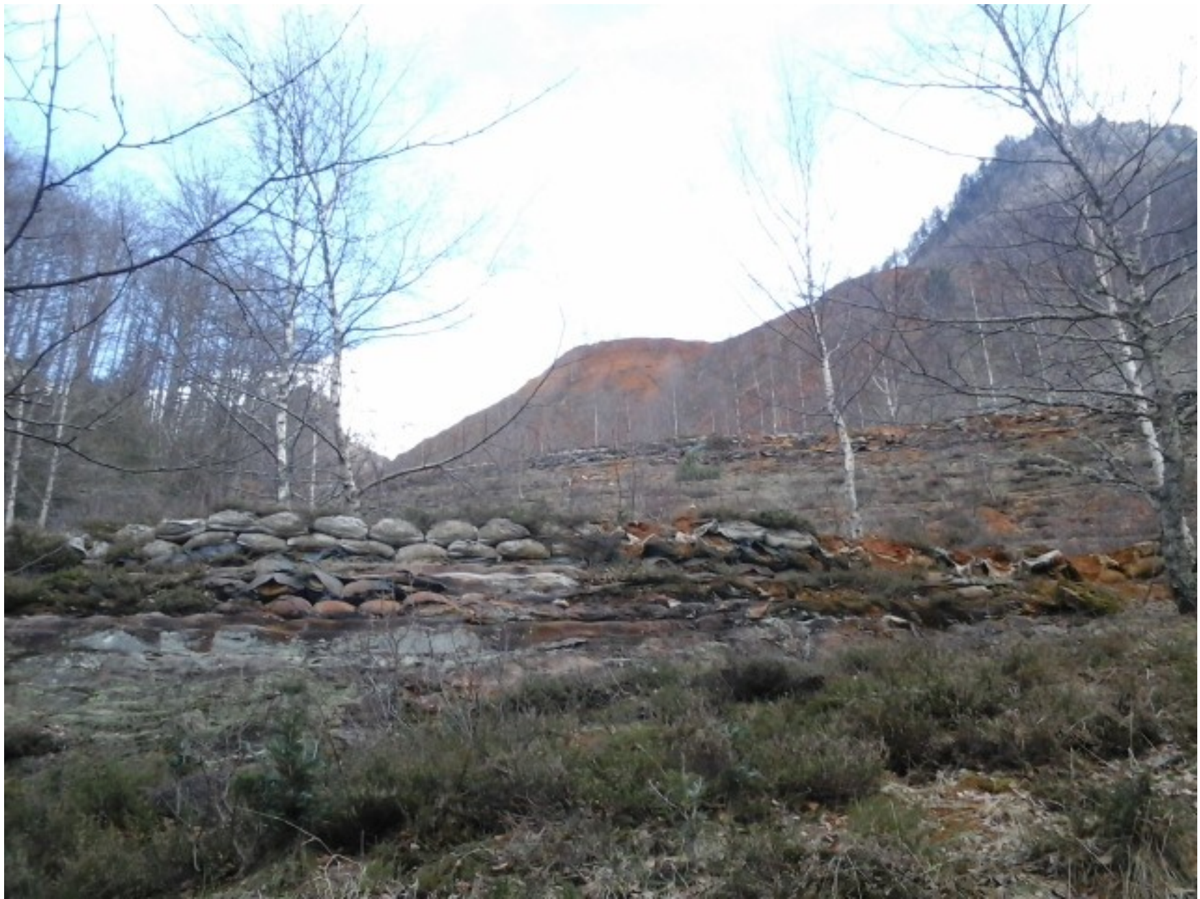
Les digues de retenue des stériles très dégradées
